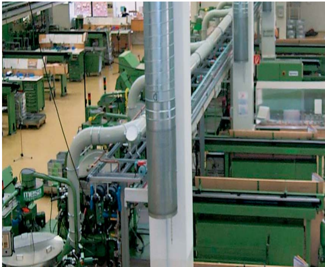
Abb. 20: Maschinenhalle mit Messstelle
