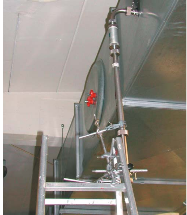
Abb. 9: IPS in der Abluft einer RLT-Anlage
