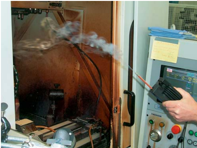
Abb. 23: Einregulierung des Abluftvolumenstromes mit Strömungsprüfröhrchen
