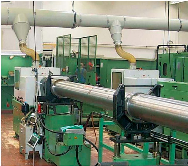
Abb. 11: Maschinenhalle mit Messstelle
