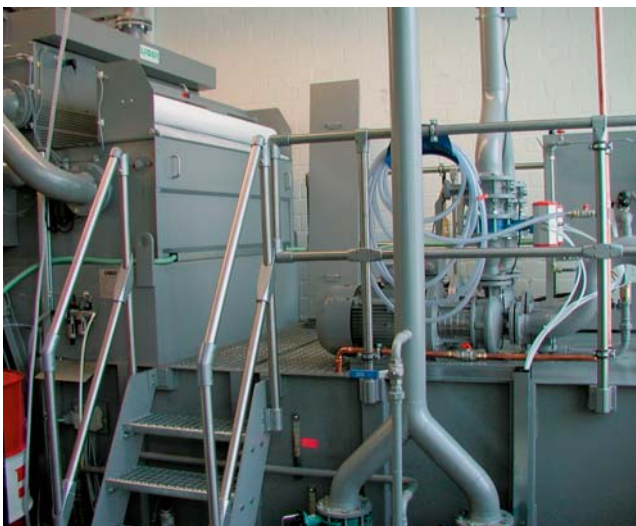
Abb. 22: Zentralanlage zur Pflege von KSS
